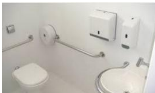
FIGURA 2 - BANHEIRO ADAPTADO A PESSOAS COM DEFICIÊNCIA
